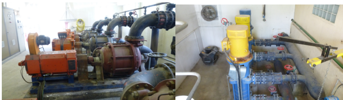
Equipements conservés ou réutilisés dans le projet (stations de reprise)
